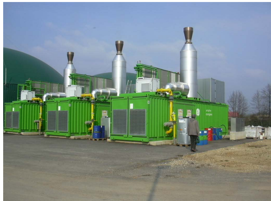
Gázmotorok biogázüzemben Lendván (Szlovénia)
